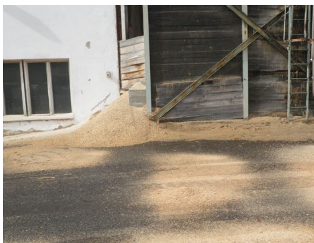
Únik pilin do vnějšího prostředí na pile Protivín
