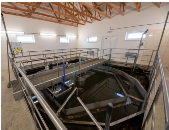
Pohled na vnitřní část technologie ČOV Strílky
