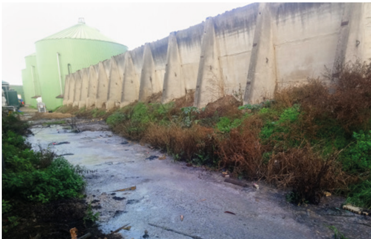
Únik digestátu v areálu bioplynové stanice
