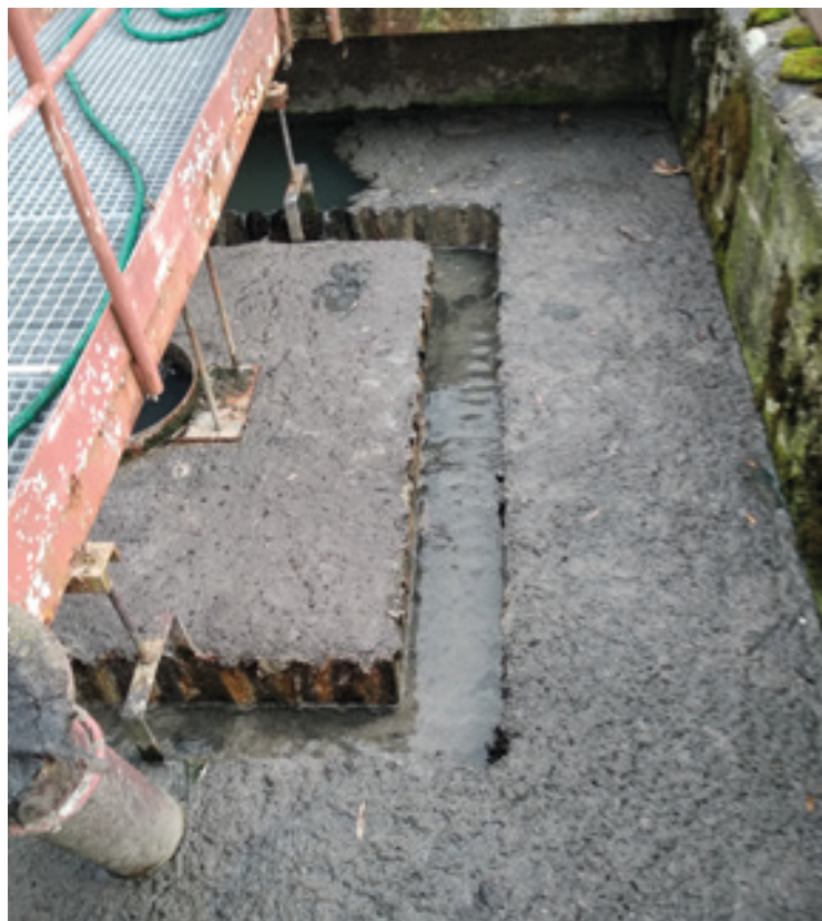
Pohled na vnitřní část technologie
