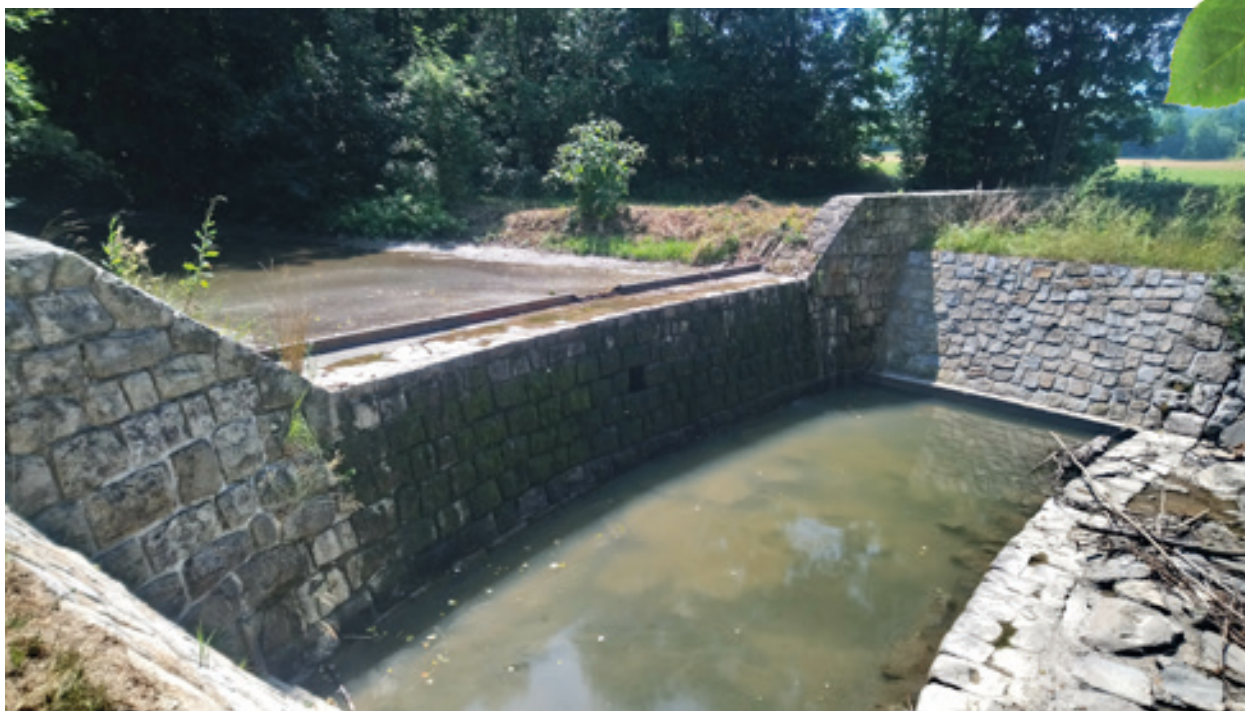
Nedodržení minimálního zůstatkového průtoku
