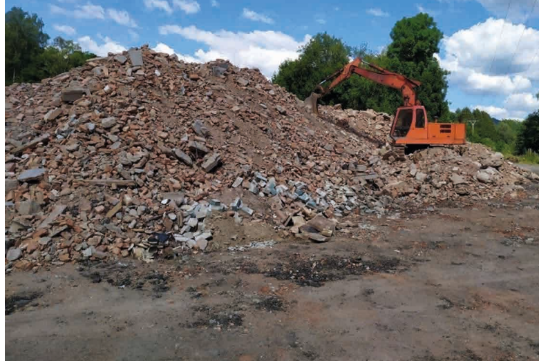
Nelegální nakládání s demoličními odpady pocházejícími z demolice na pozemcích v k.ú. Plavy
