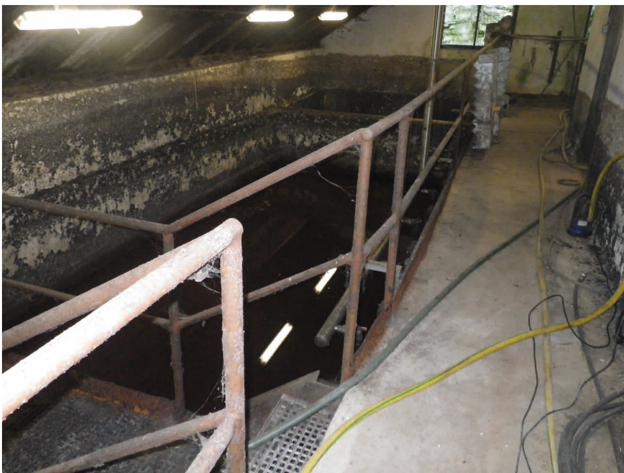
Pohled na neudržovanou vnitřní část technologie
