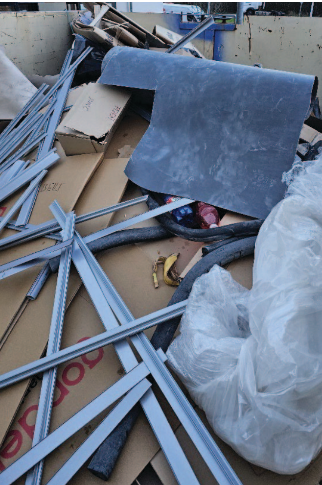
Kontrola původce odpadů – ukázka nesprávného třídění odpadů
