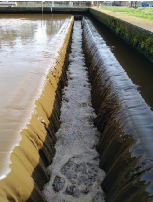
Odtok z regenerační nádrže kalu na ČOV
