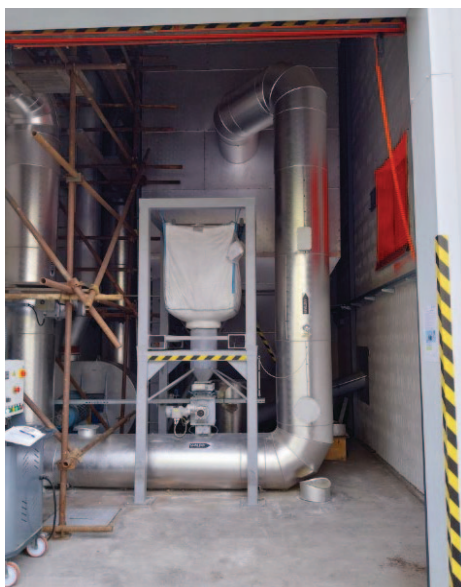
Filtrovní stanice – spalovna nebezpečných odpadů v Pardubicích
