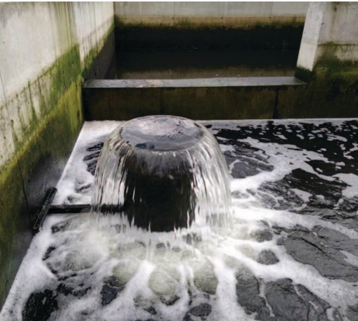
Odtok z regenerační nádrže kalu na ČOV
