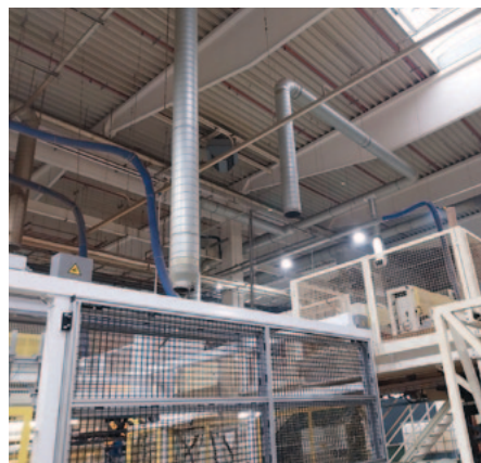
Obr. Odpojená zařízení linek od vzduchotechniky vedoucí k filtračním zařízením na snižování VOC
