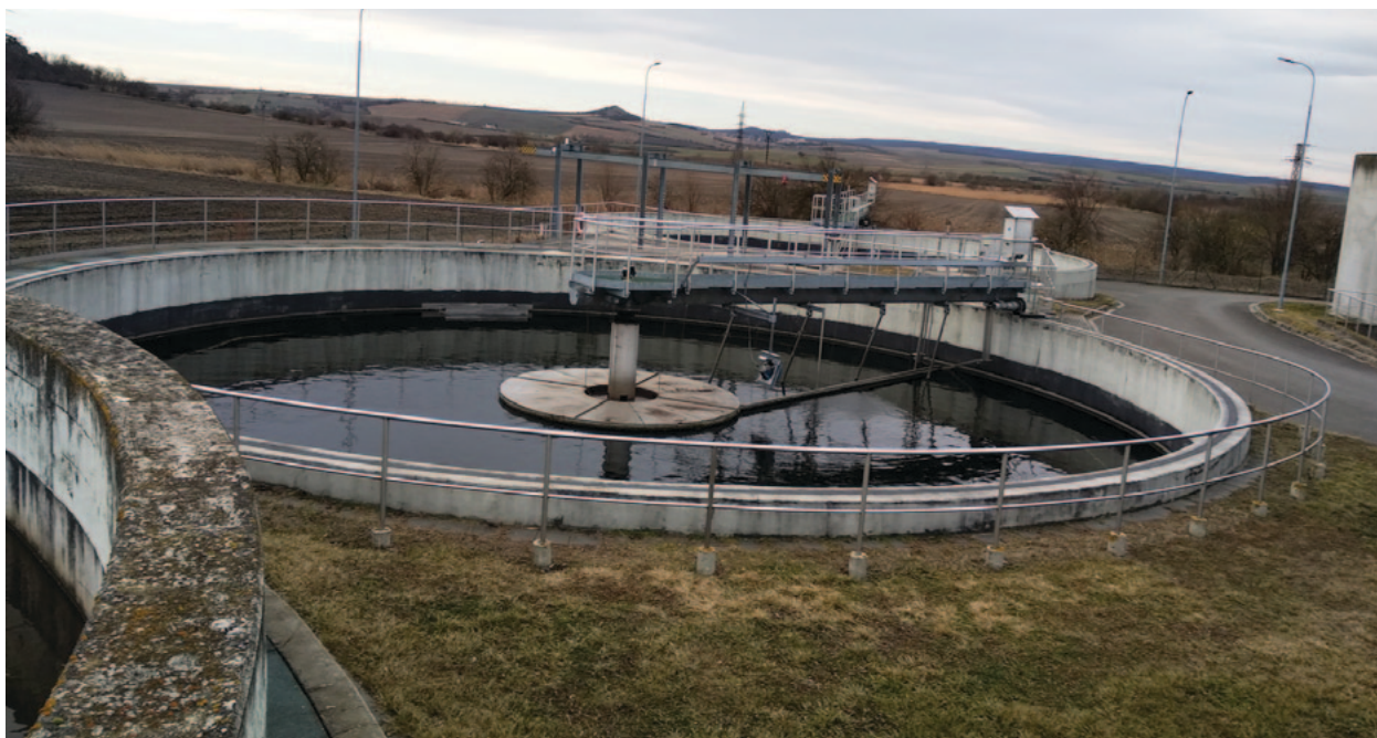
ČOV – dosazovací nádrže
