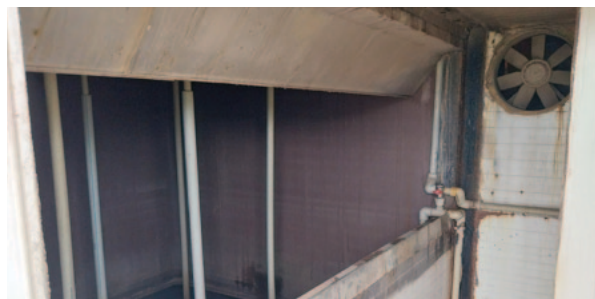
Výpadky v provozu vodní pračky vzduchu, přestože má trvale odsávat příjmovou halu surovin pro omezení emisí pachových látek
