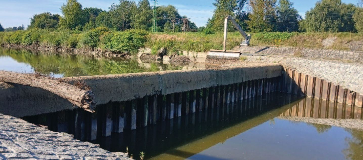
Nedodržení minimálního zůstatkového průtoku při provozu malé vodní elektrárny
