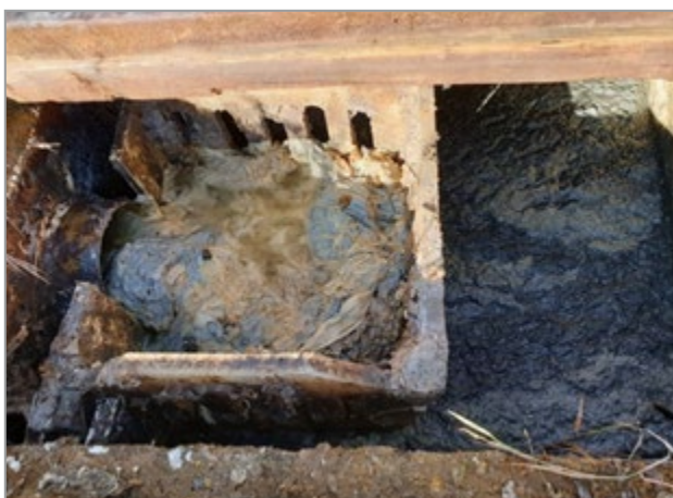
Nevyčištěný česlicový koš čistírny odpadních vod Penzionu Hájenka na Knížecích Pláních.
