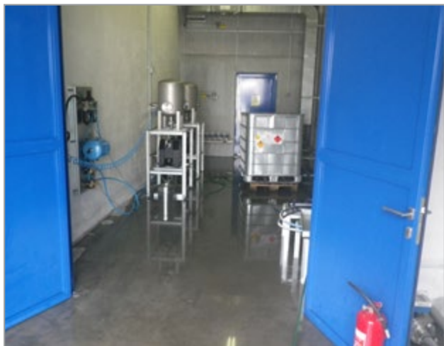
Zbytky uniklého ethylacetátu na podlahu místnosti s čerpadly ve společnosti Amcor Flexibles Nový Bydžov.
