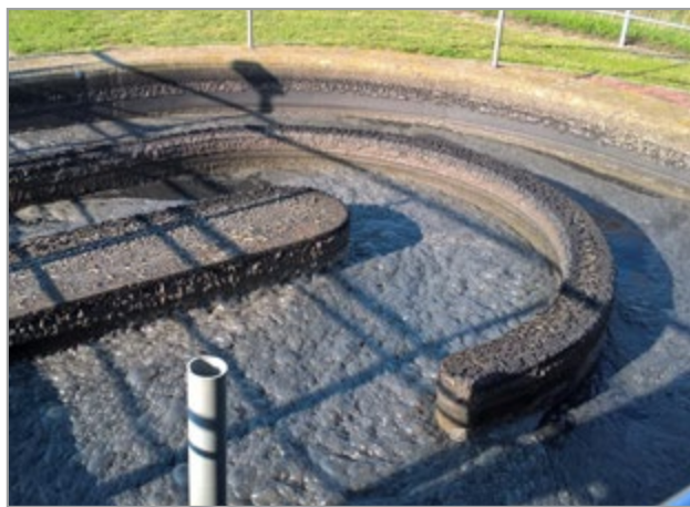
Provoz čistírny odpadních vod pro 2000 až 10 000 EO.
