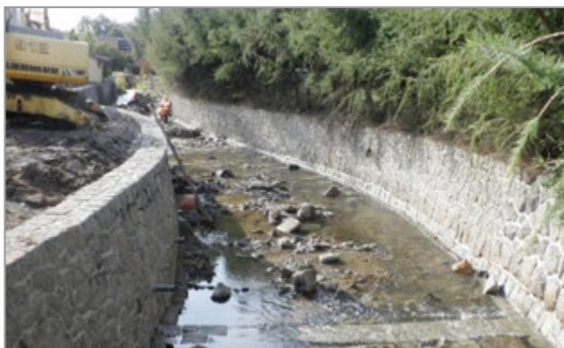
Stavba opevnění Boberského potoka prováděná v rozporu s požadavky na ochranu zvláště chráněného druhu vranky obecné.
