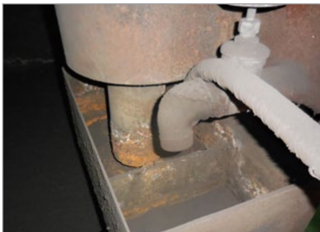
Mokrý hladinový odlučovač, který společnost IRON & STEEL provozovala z rozporu se schváleným provozním řádem bez vody.
