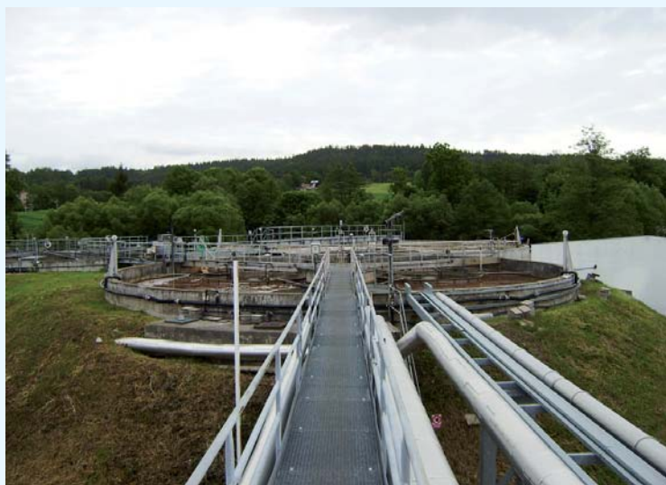
ČOV v Kostelci u Jihlavy
