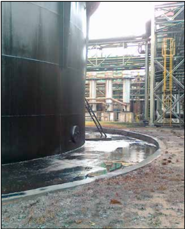
Havárie – Sokolovská uhelná, právní nástupce, a.s.
