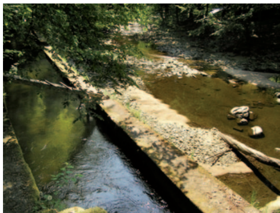
Kamenice – přívodní kanál na derivační MVE
