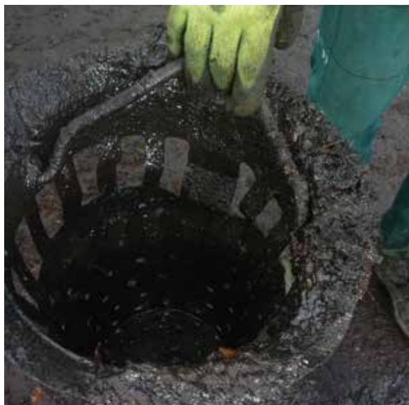
Pohled na kanalizační šachtici znečištěnou ropnými látkami v areálu společnosti Mayr-Melnhof Holz Paskov s.r.o.
