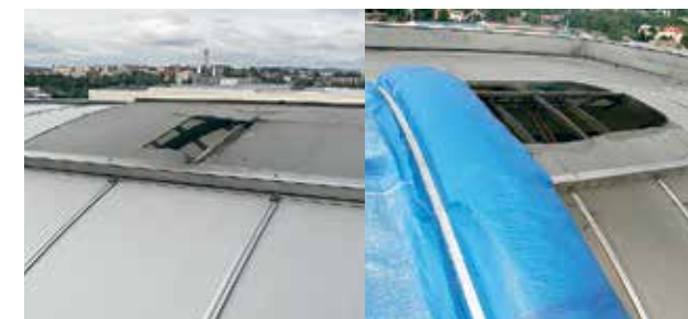
Poškozené světlíky společnosti KRONOSPAN OSB s.r.o.
